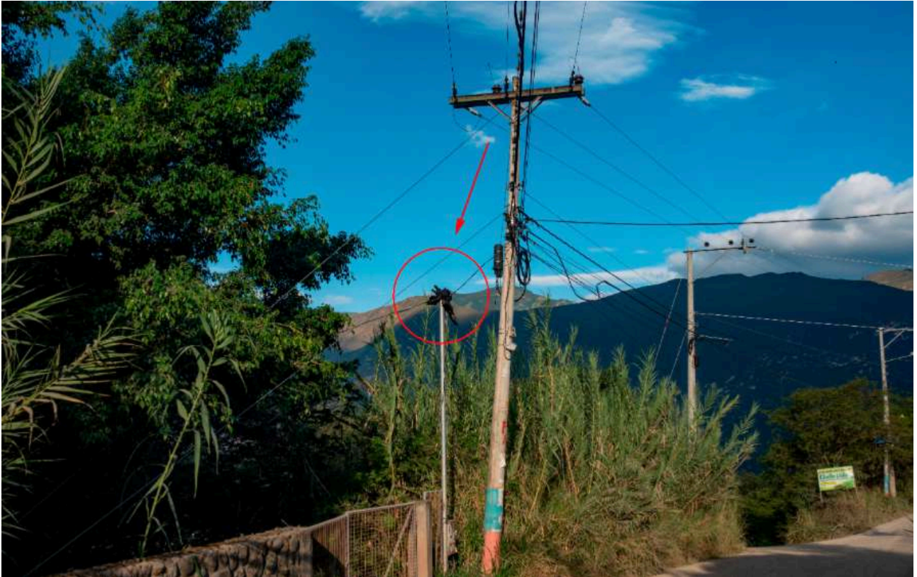
Figura 1. Torreta de transmisión eléctrica donde se produjo el evento de mortalidad de Gallinazo Negro, ( Coragyps atratus ) electrocutado, 16 de julio de 2023 © Paul A. Molina.
