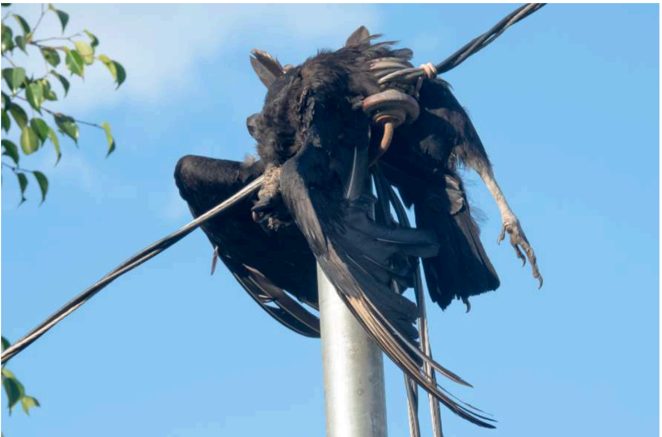
Figura 2. Individuo de Gallinazo Negro, ( Coragyps atratus ) electrocutado, al caerse se ha quedado enganchado en uno de los elementos de la línea eléctrica. 16 de julio de 2023 © Paul A. Molina
